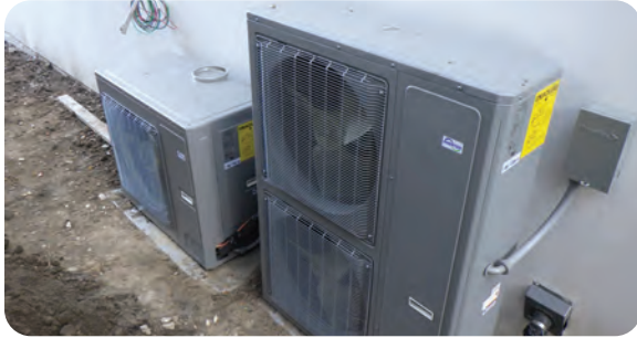
Heating and Cooling Calefacción y enfriamiento
