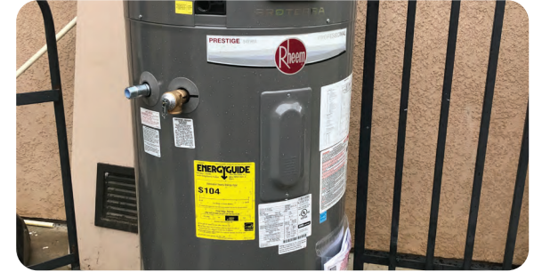
Water Heater Agua caliente
