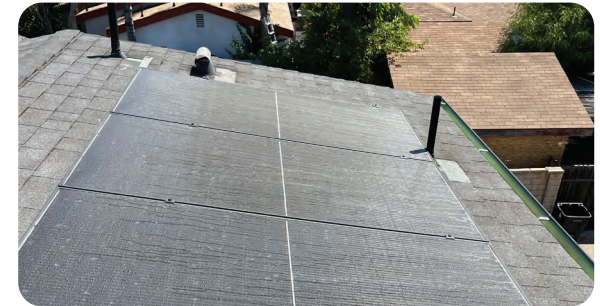
Solar PV Solar
